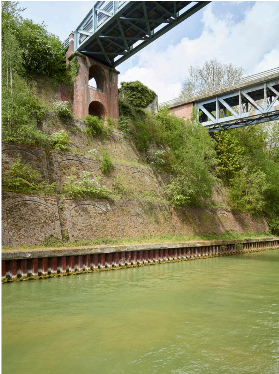
Vue vers les deux ponts métalliques. Aperçu des murs de soutènement en gradins et de la culée du pont sud.
