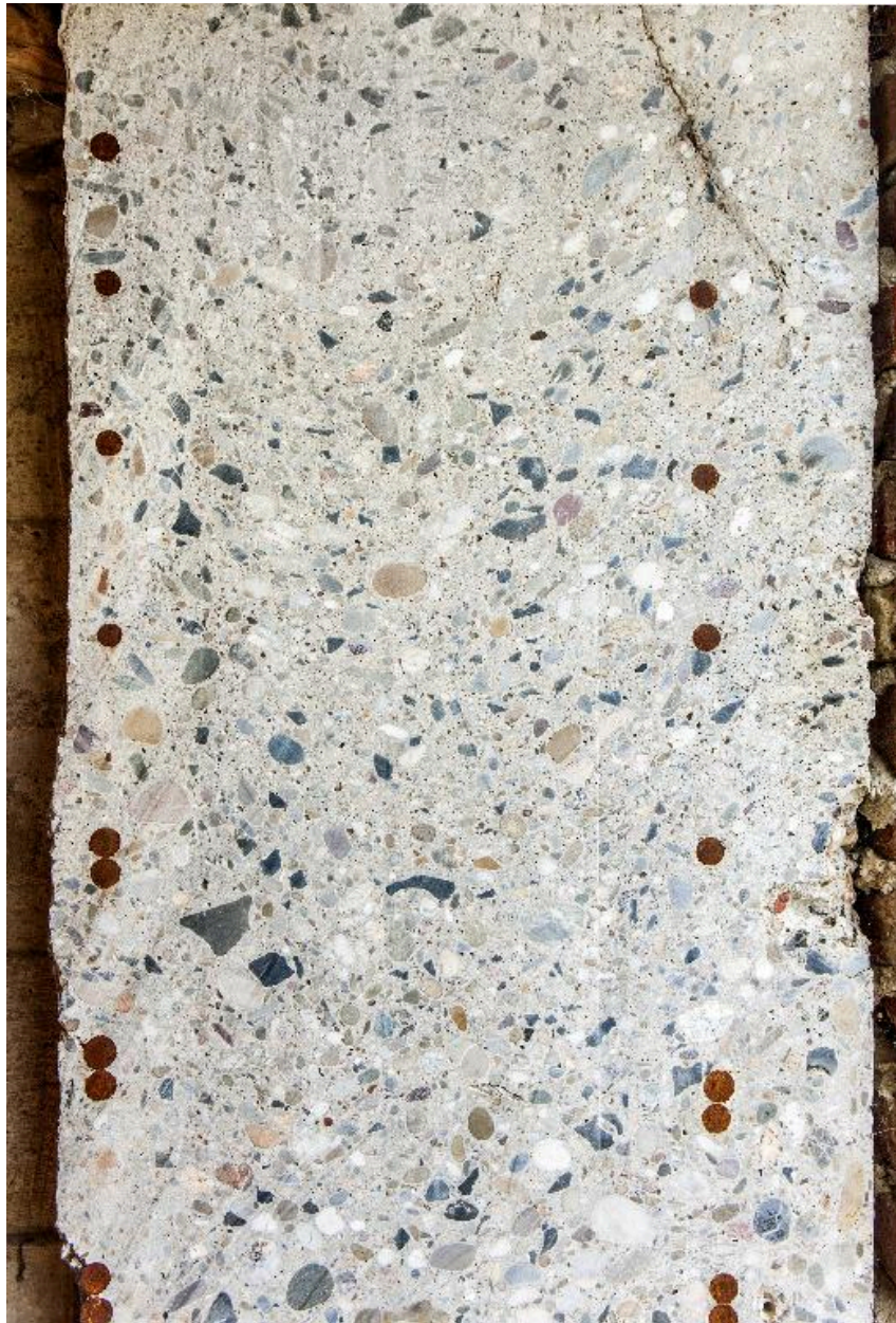
Partie tronçonnée du mur sud-est de la casemate laissant voir le ferrailage en coupe.
