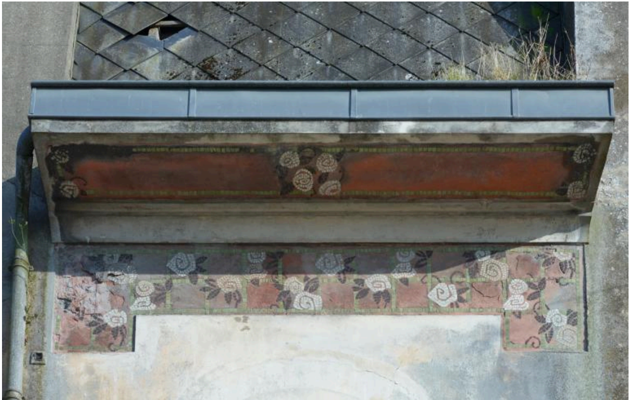
Vue de détail du décor de sgraffito qui soulignait les baies du premier étage de l'ancien hôtel aujourd'hui murées.
