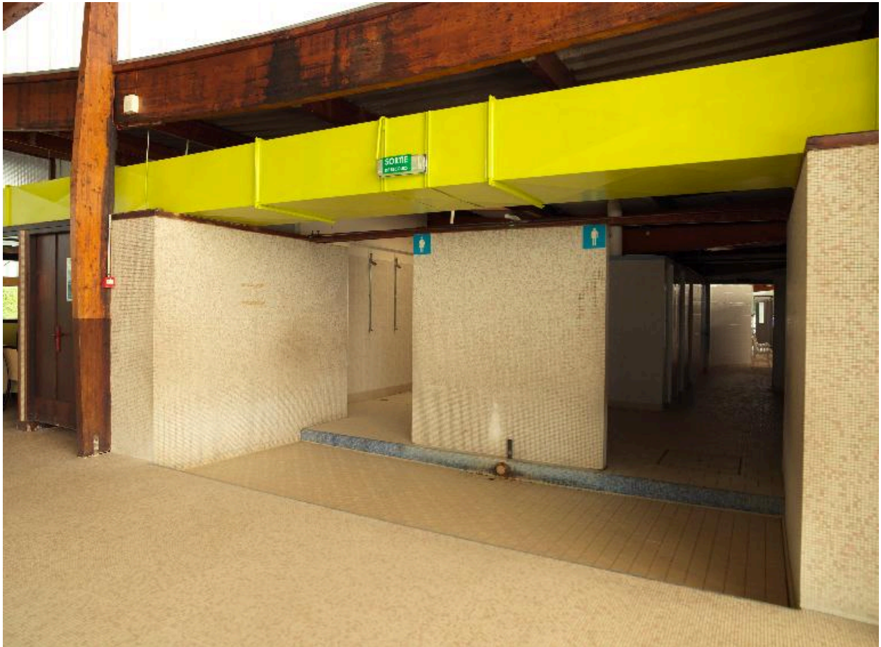
Pédiluve d'accès aux bassins depuis les douches et les vestiaires.
