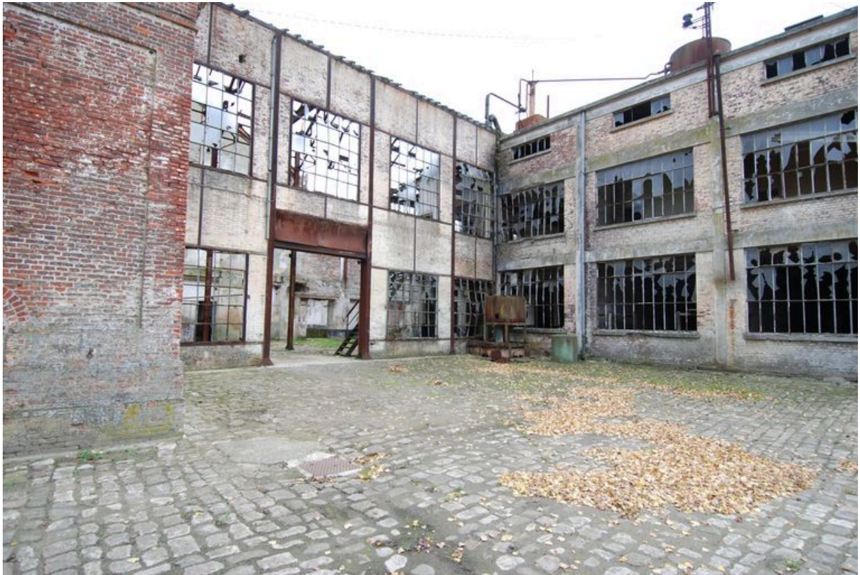
Façade sur cour de l'atelier de fabrication et du laboratoire en retour. Au premier plan, base de la cheminée.
