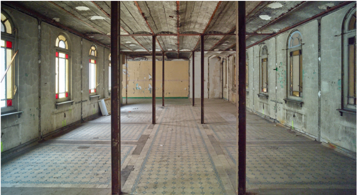
Aile nord, rez-de-chaussée. Vue générale depuis l'entrée des anciens bains de baignoires de luxe pour dames.
