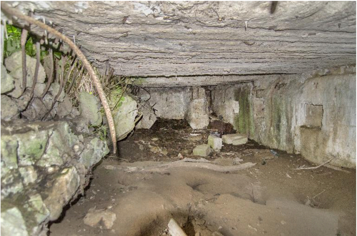
Salle principale, explosée au sud. Dans le fond, le départ de la coursière de tir
