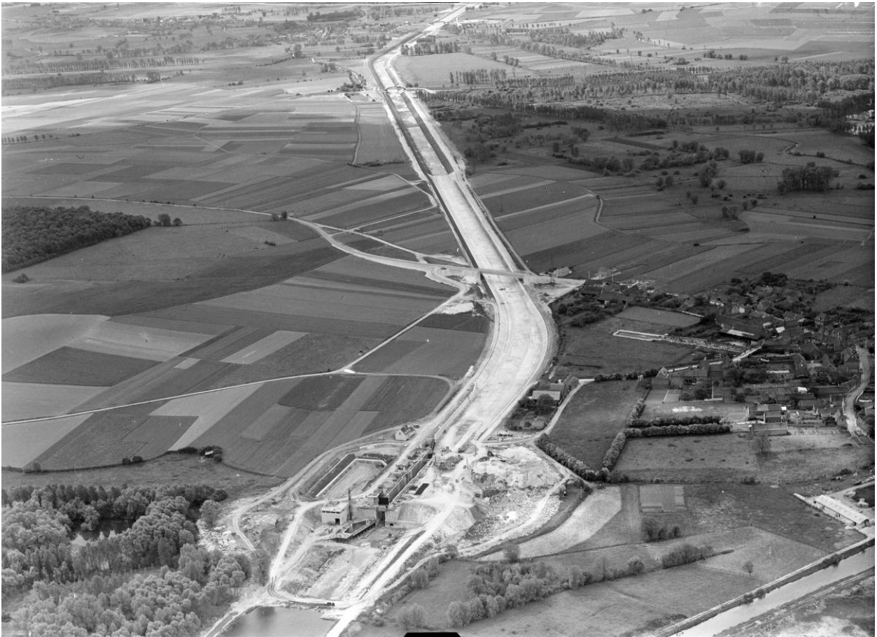
Vue aérienne du chantier dans le secteur de l'écluse n°1 de Palluel (Pas-de-Calais) en 1965. (IGN. Photothèque Nationale. 1965).
