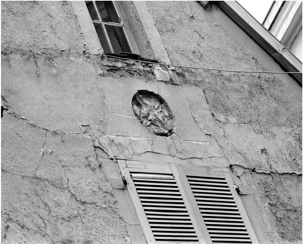
Détail d'un médaillon manquant sur le pignon.
