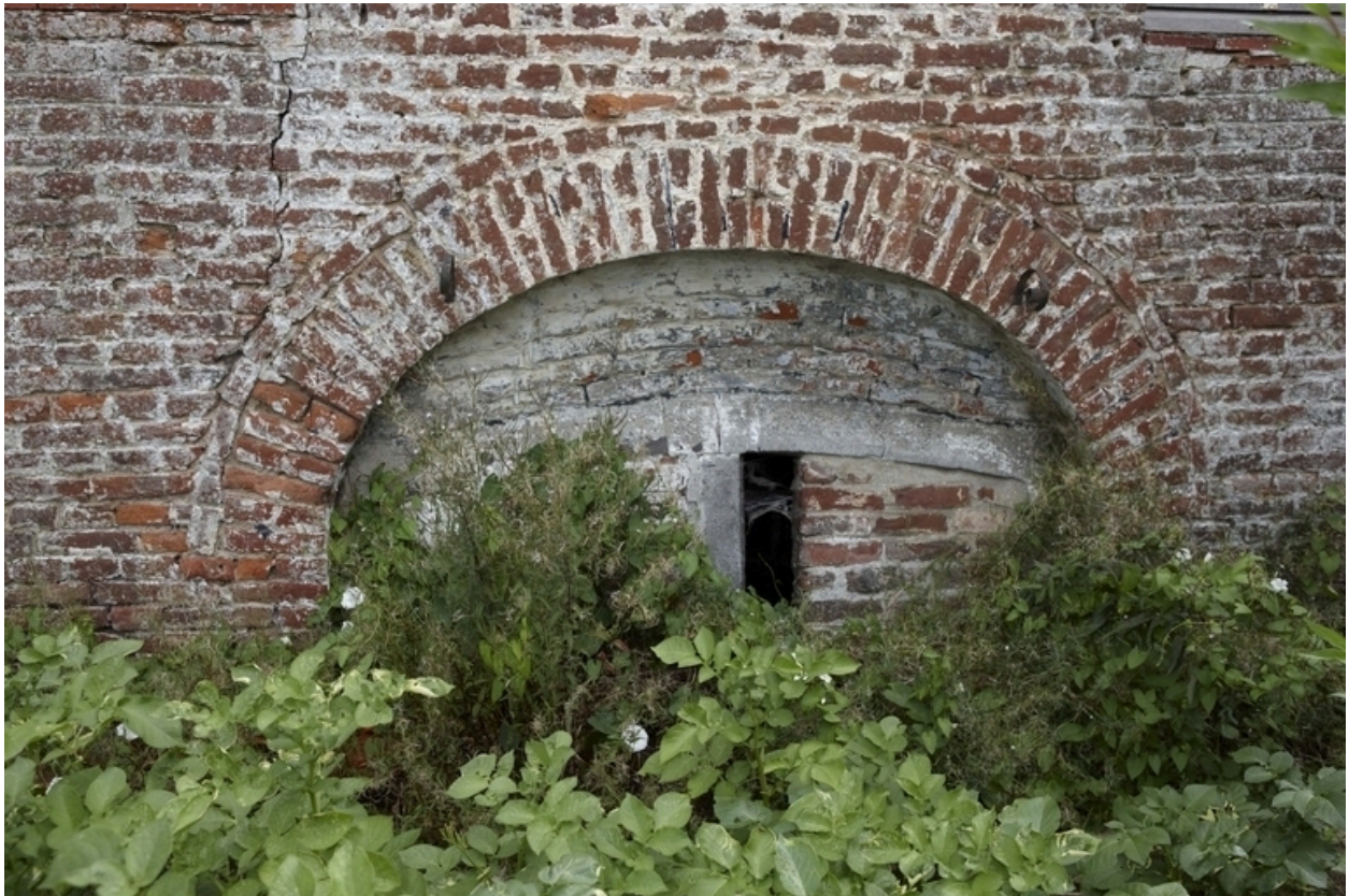
Détail de la blocure située en pignon.
