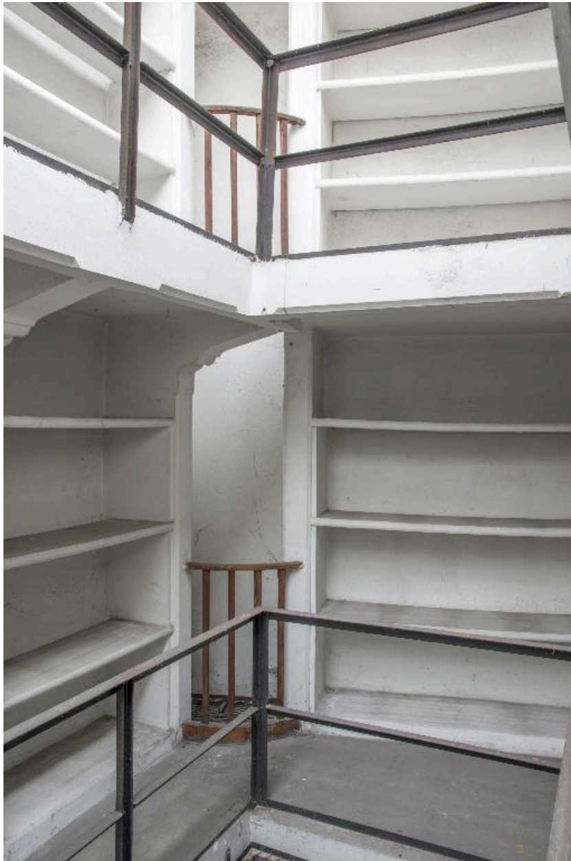
Bâtiment du dépôt, deuxième étage : vue du système d'aération du vaisseau 2, au nord-est.
