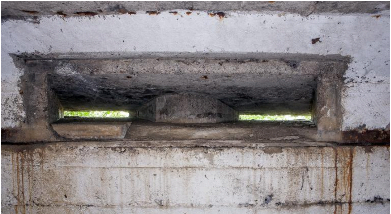
Salle est, détail du poste de surveillance.
