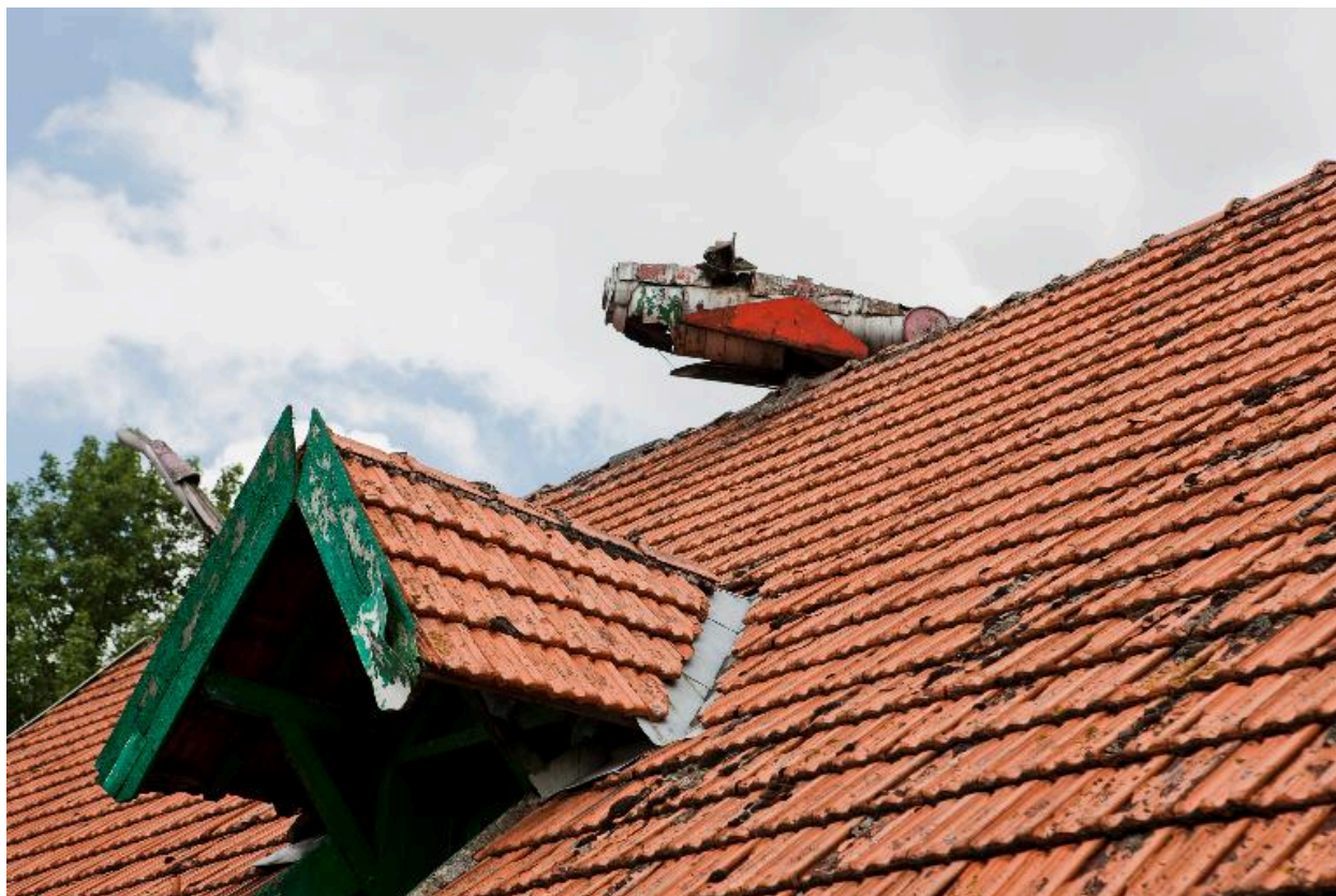
Avion sur le toit de la porcherie.
