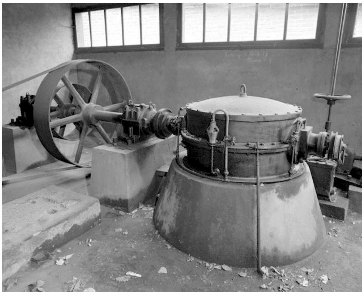
Bâtiment d'eau, vue intérieure.
