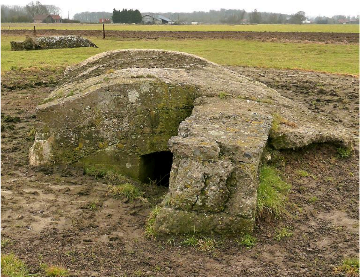
Vue des deux casemates, vers le sud. Au premier plan, l'entrée nord et son mur pare-souffle
