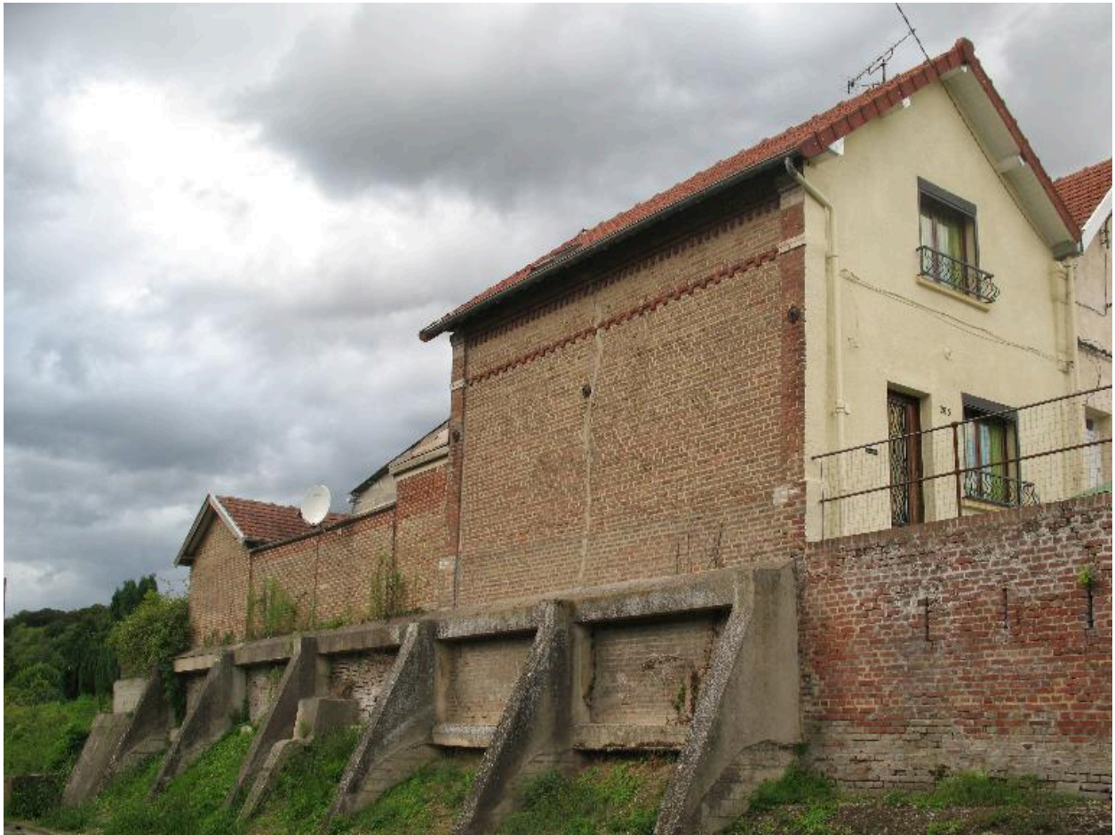
Contrefort de terrasse en béton armé rachetant le dénivelé à l'aplomb du logement.
