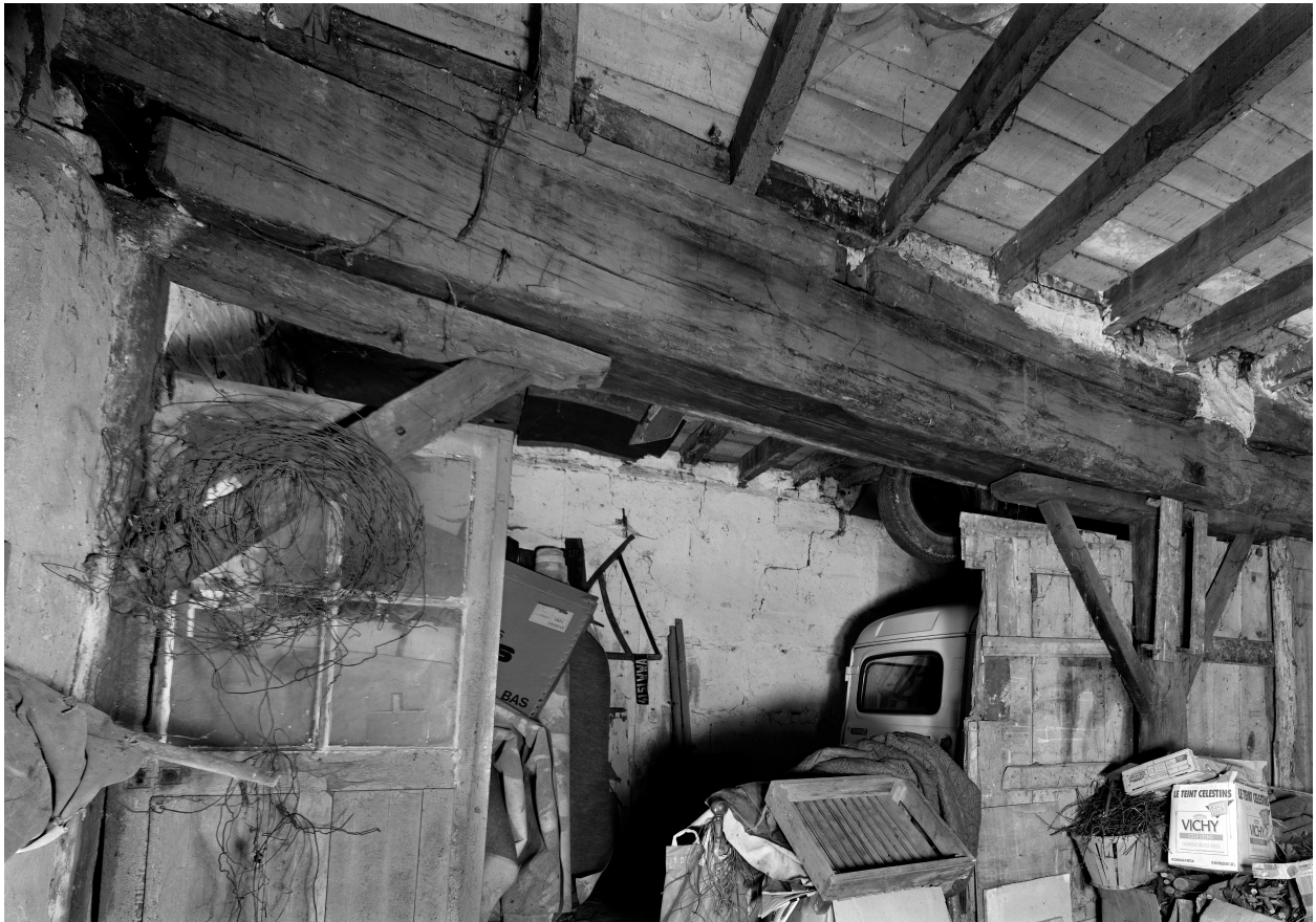
Poutre maîtresse du rez-de-chaussée.
