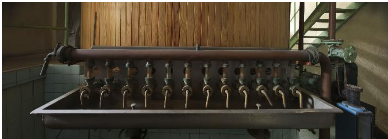
Détail des robinets de la cuve de filtration.
