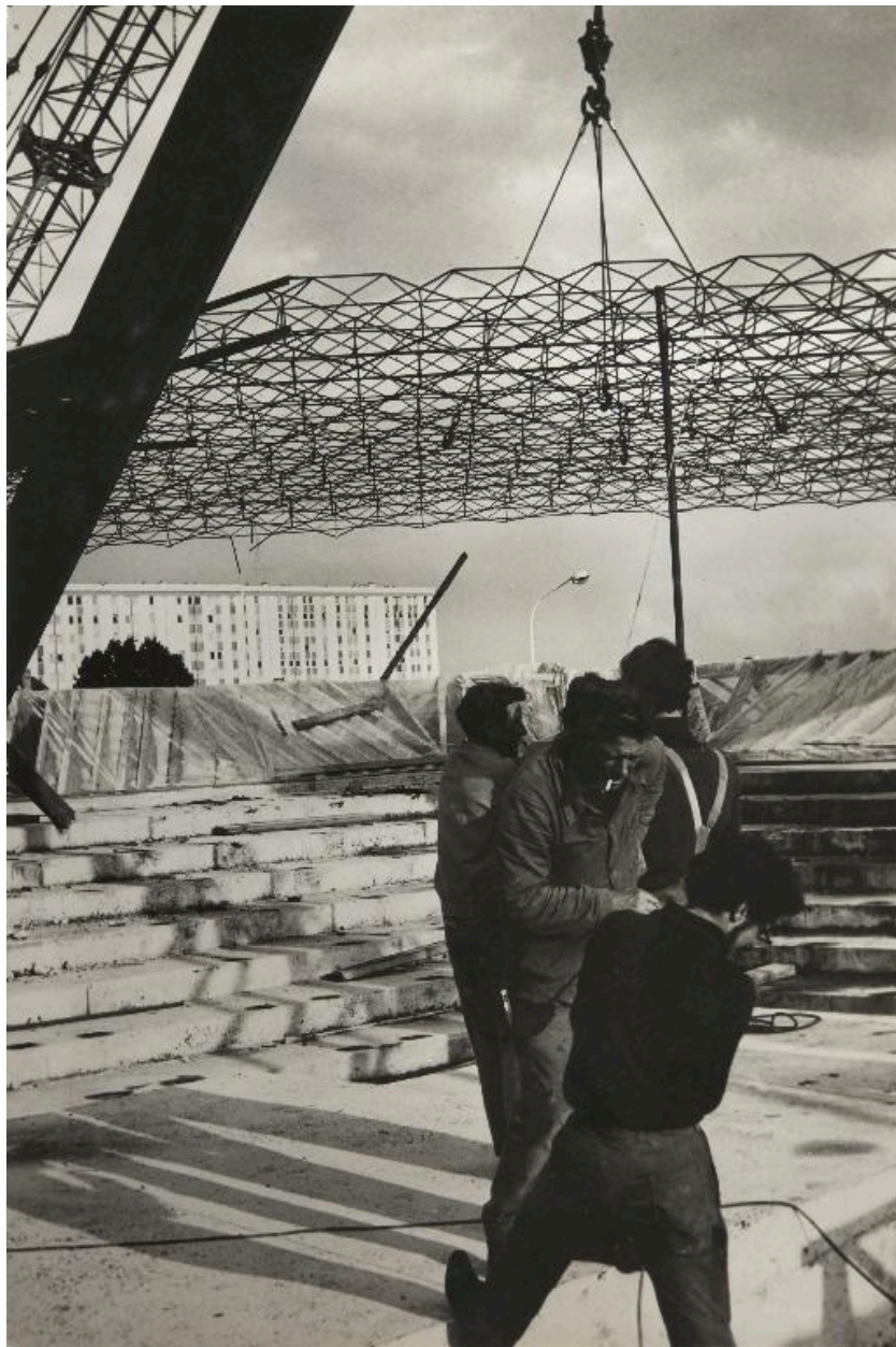
L'édifice en cours de construction. Pose de la résille en métal. Photographie, vers 1970. AP Jean XXIII, Saint-Quentin.
