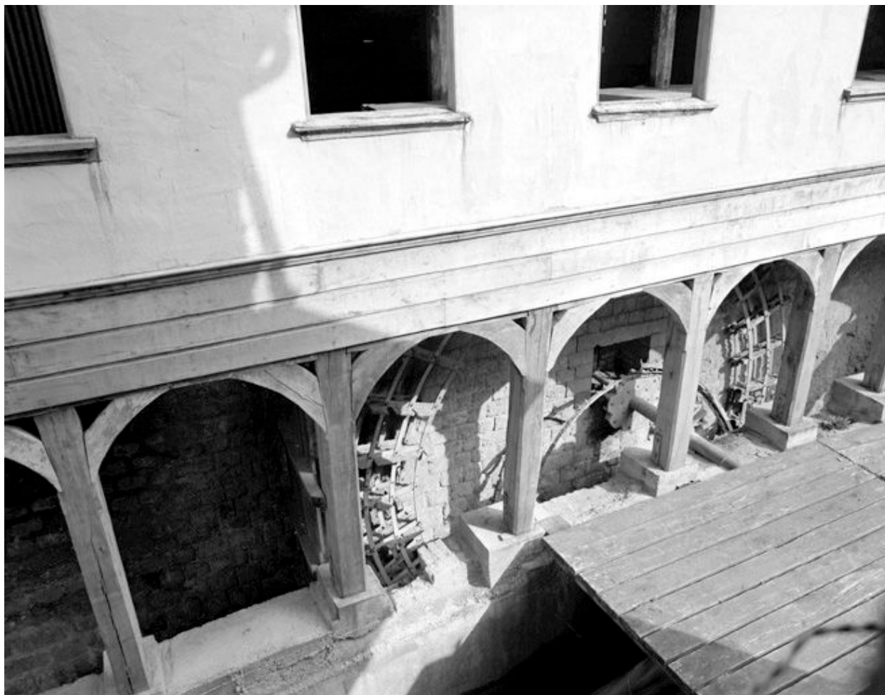
Coursier et roue hydraulique.
