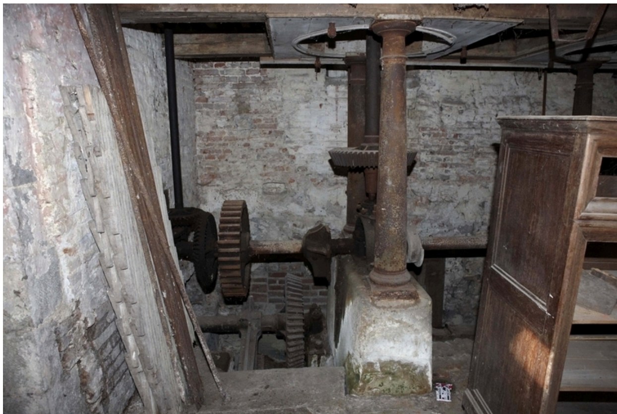
Vue de l'arbre moteur et des embrayages coniques (endommagés).
