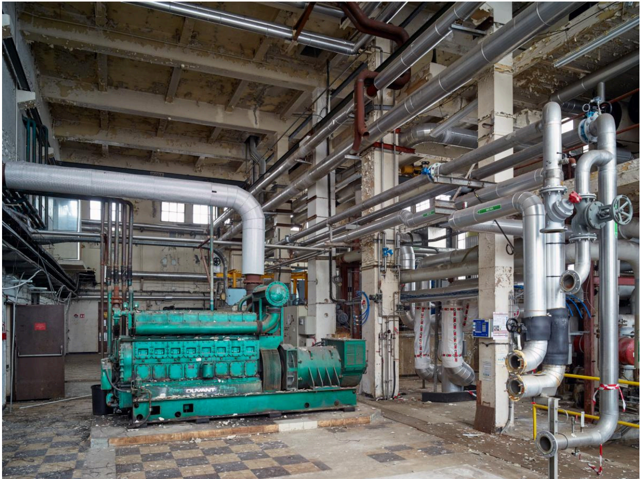
La chaufferie (A), vue intérieure. Au centre un moteur Duvant (Valenciennes) de 1978.
