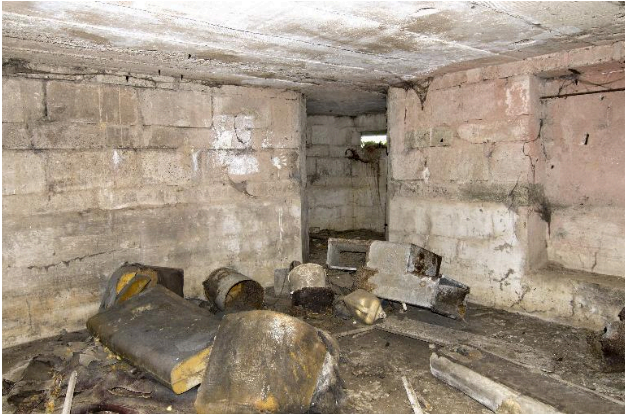
vue intérieure de la salle nord. En face l'entrée de la tourelle nord
