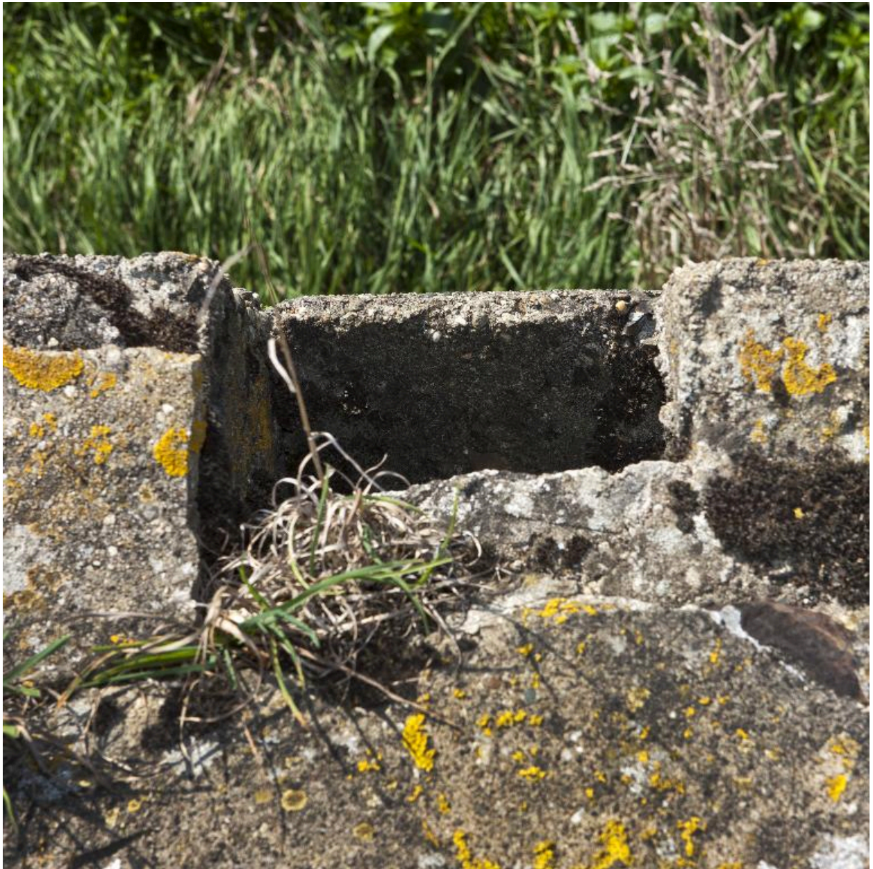
Sortie d'aération de la salle sud-est
