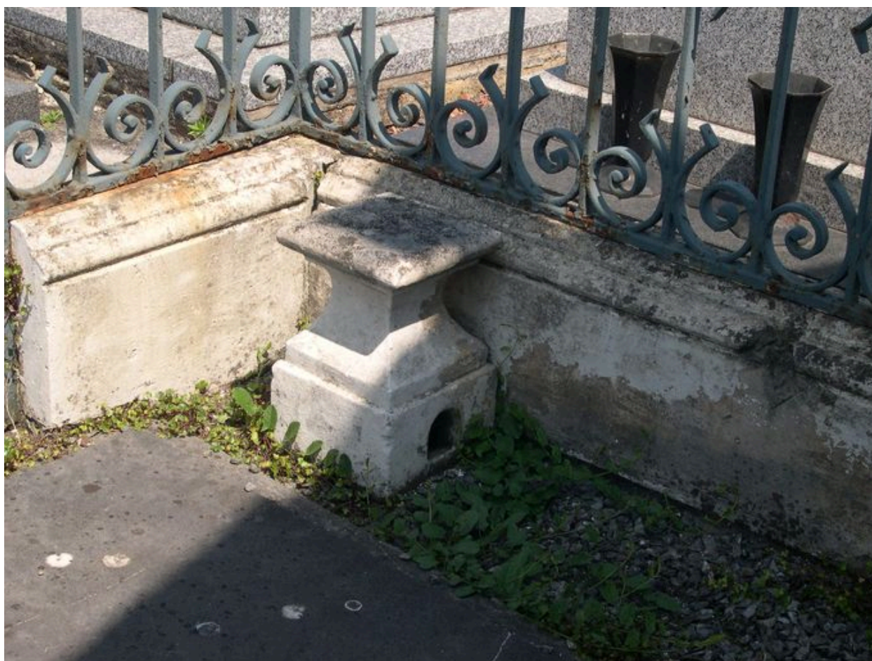
Vue d'une des bouches d'aération du caveau.
