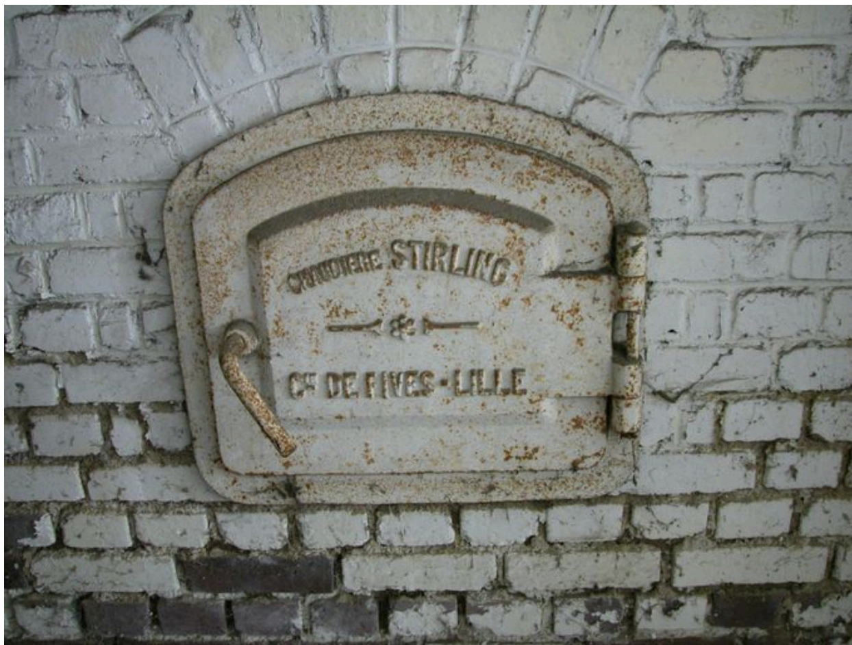
Détail de plaque de chaudière Sterling.
