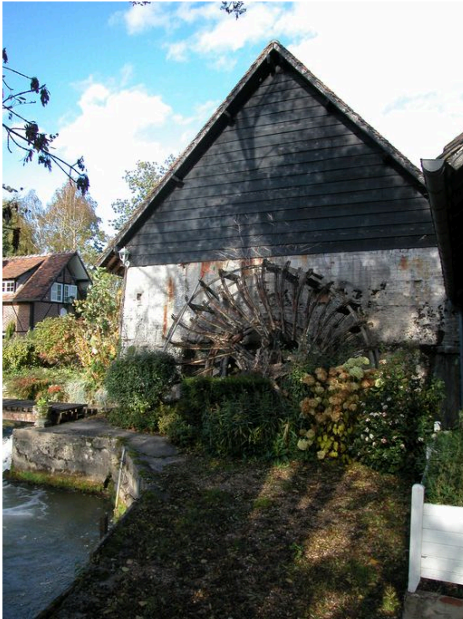
Le pignon du moulin portant la structure métallique de la roue hydraulique.
