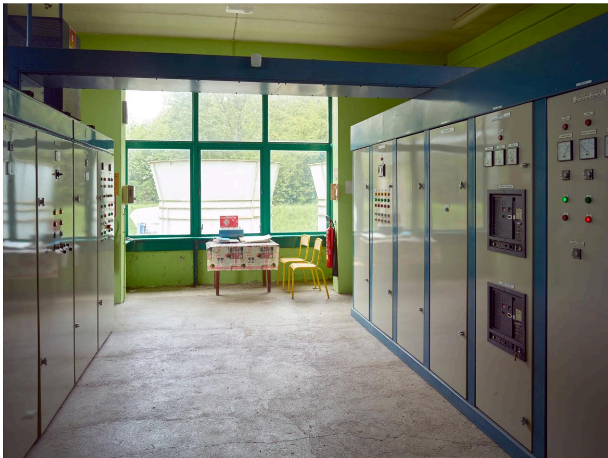
Intérieur du poste de commande et les tableaux électriques. Vue vers le bow-window.
