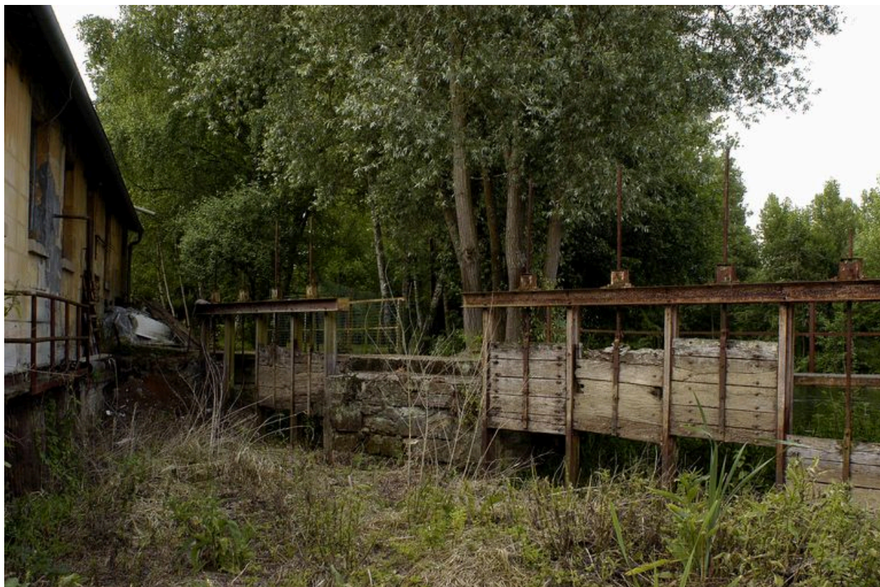
Vannage de décharge du canal d'amenée.
