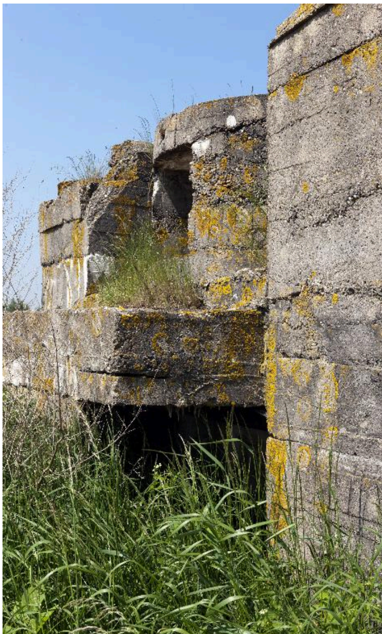
Vue latérale de la banquette de tir et du support de mortier
