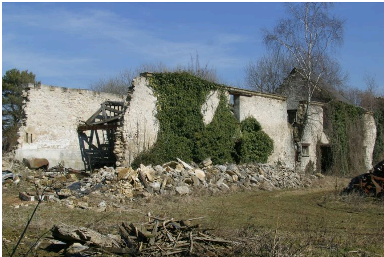
Etat actuel de la grange en ruines.
