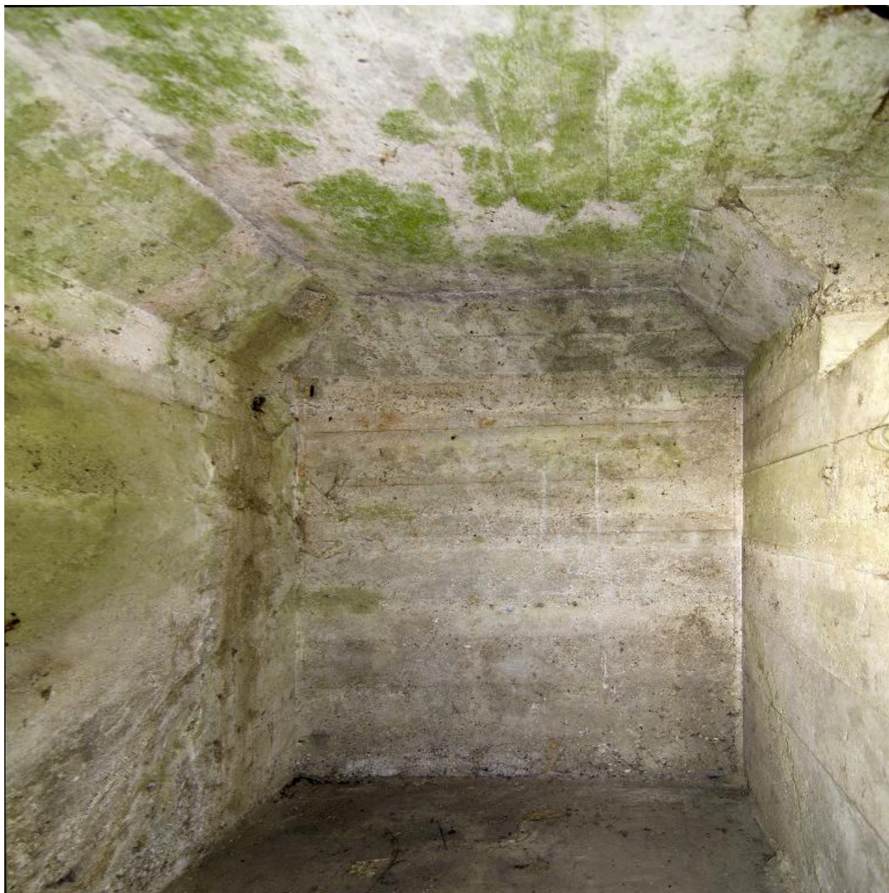
Guérite casematée (Bat. A). Vue intérieure du mur nord (au grand angle)
