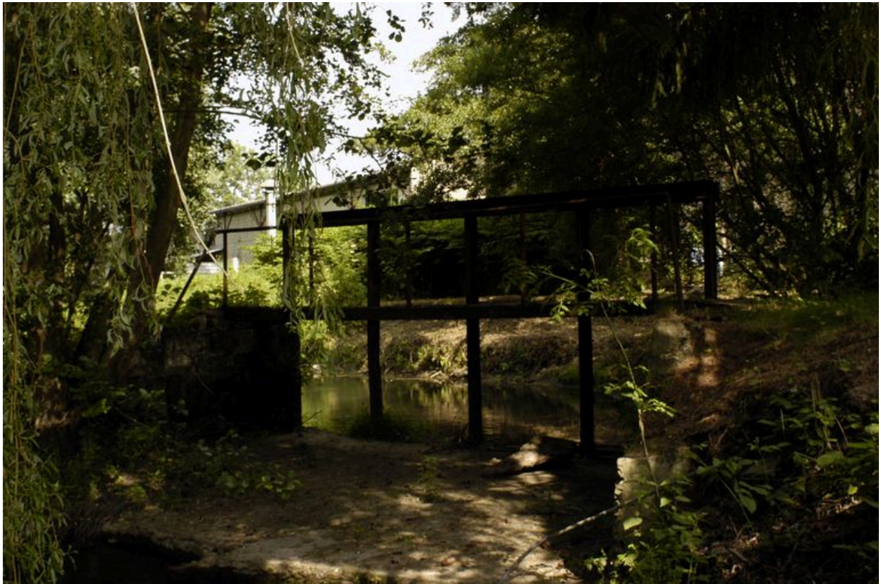
Vannage de décharge principal et déversoir.
