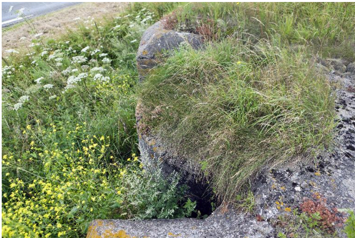
Plate-forme circulaire envahie par la végétation.
