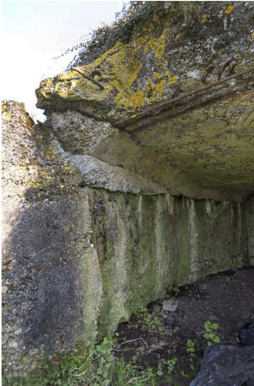
Chambre de tir, détail de la jonction du couverture avec le mur nord-est
