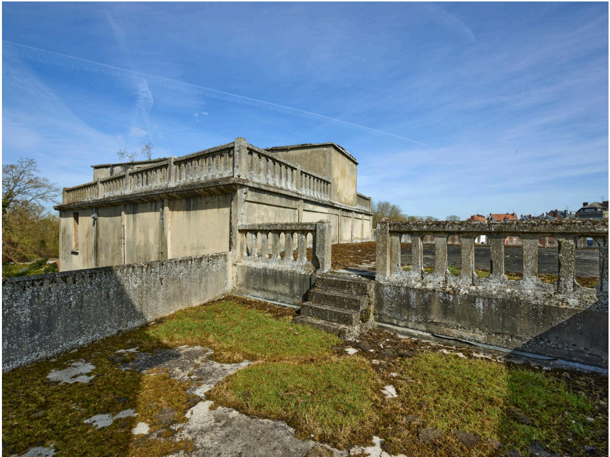
Les différents niveaux des toits-terrasses de la minoterie et l'escalier de liaison.
