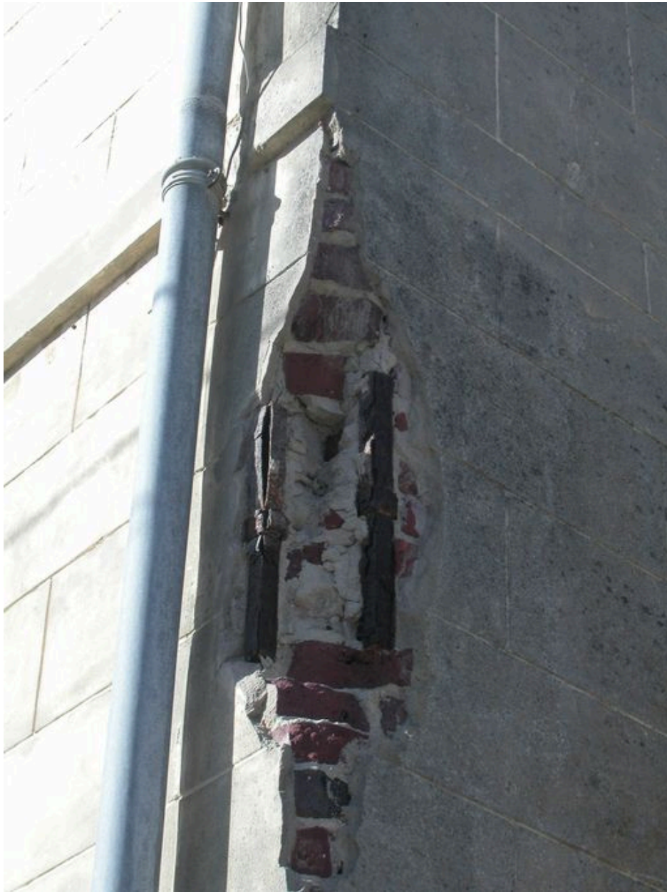
Détail d'une chaîne d'angle dégradée.
