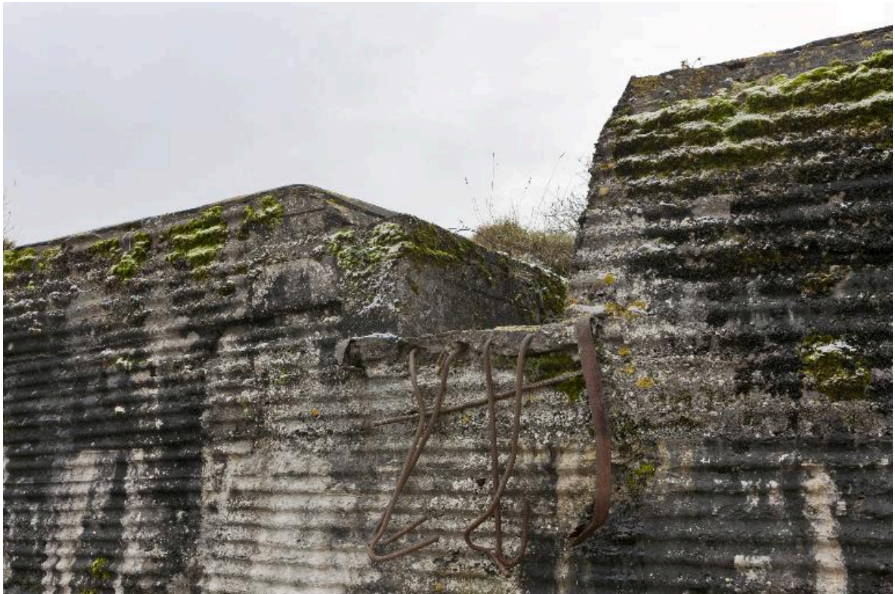
Élévation nord-est, débouché de la tranchée surélevée et vestige de l'escalier d'accès.
