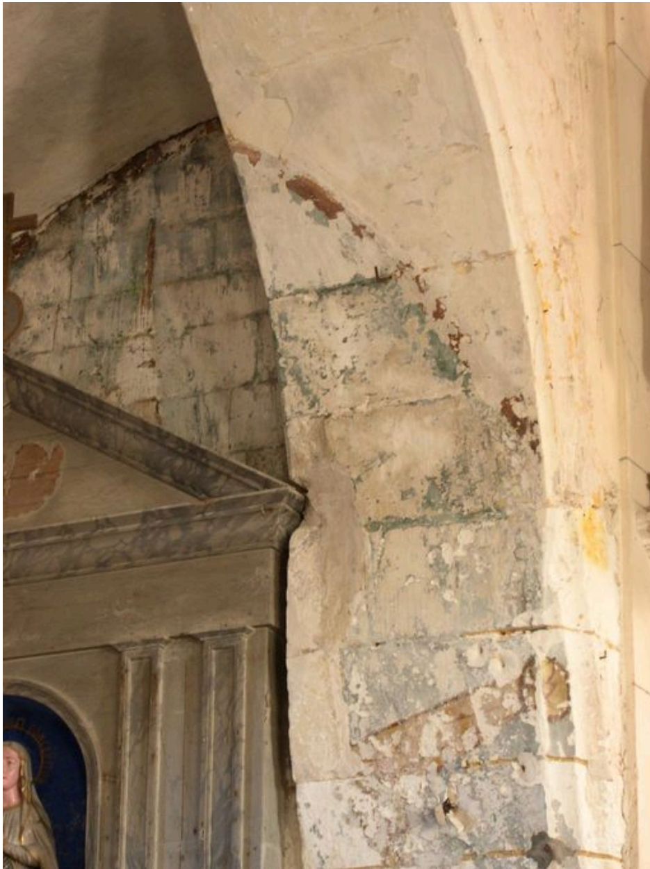
Vestiges de peinture murale, mur est du bas-côté nord.
