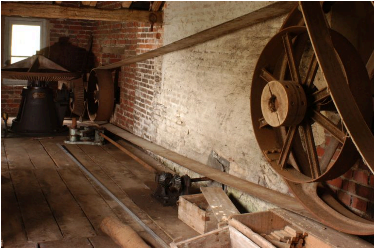
Intérieur de la salle des machines, vue d'ensemble de la turbine et de la transmission principale.
