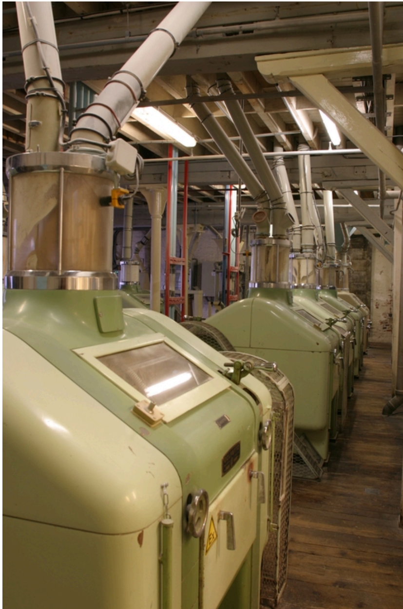
Premier étage de la minoterie : appareils à cylindres Golpetto.
