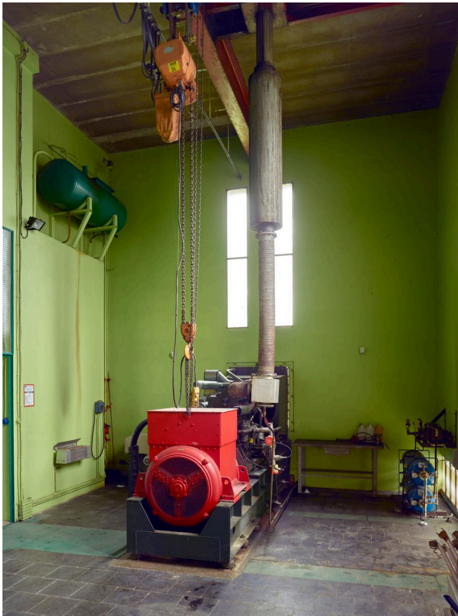
Intérieur du poste de commande. Générateur de secours. Vue vers le nord.
