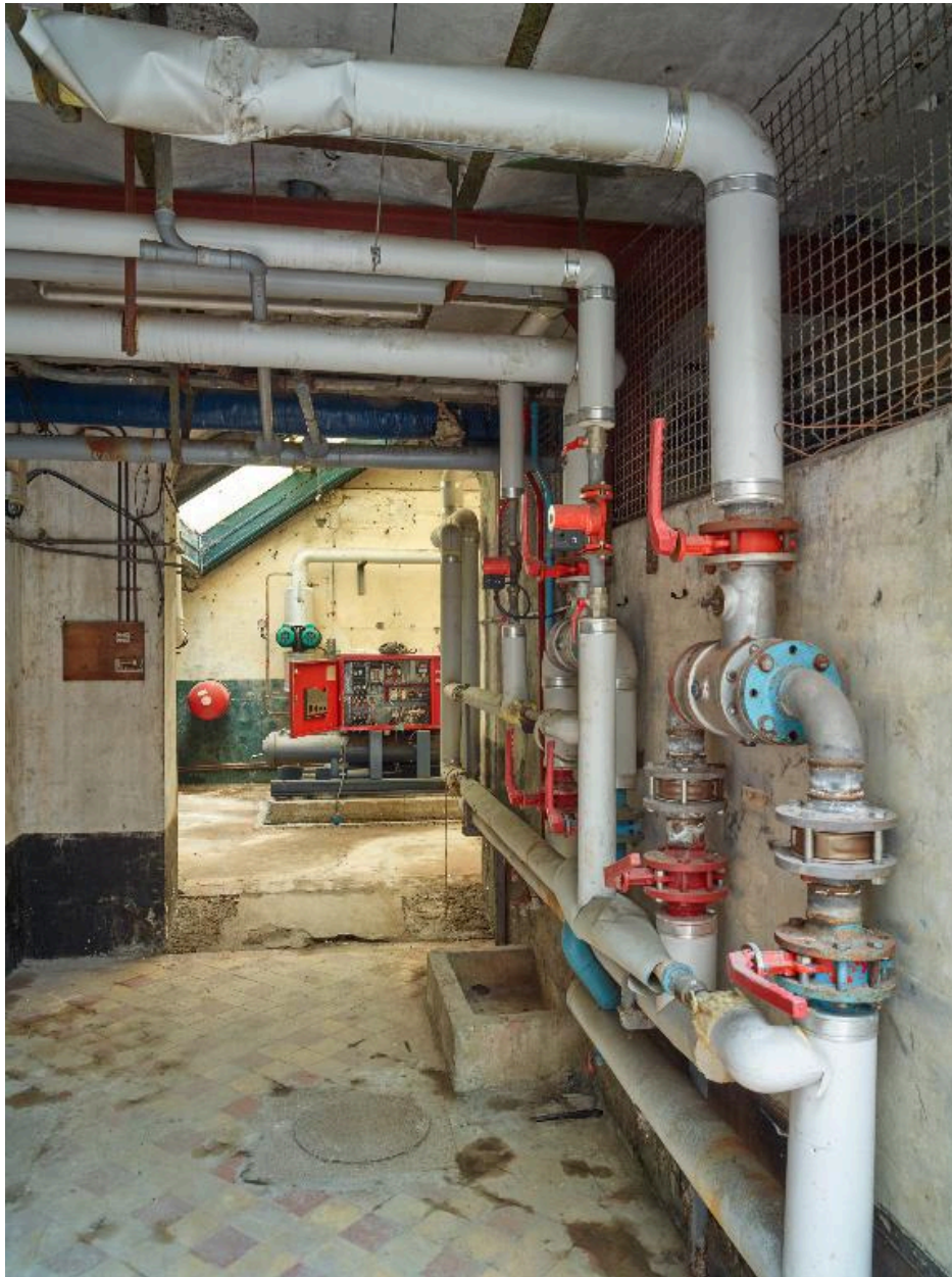
Aile sud, sous-sol. Vue partielle de la machinerie contemporaine au sud de la cour vitrée.
