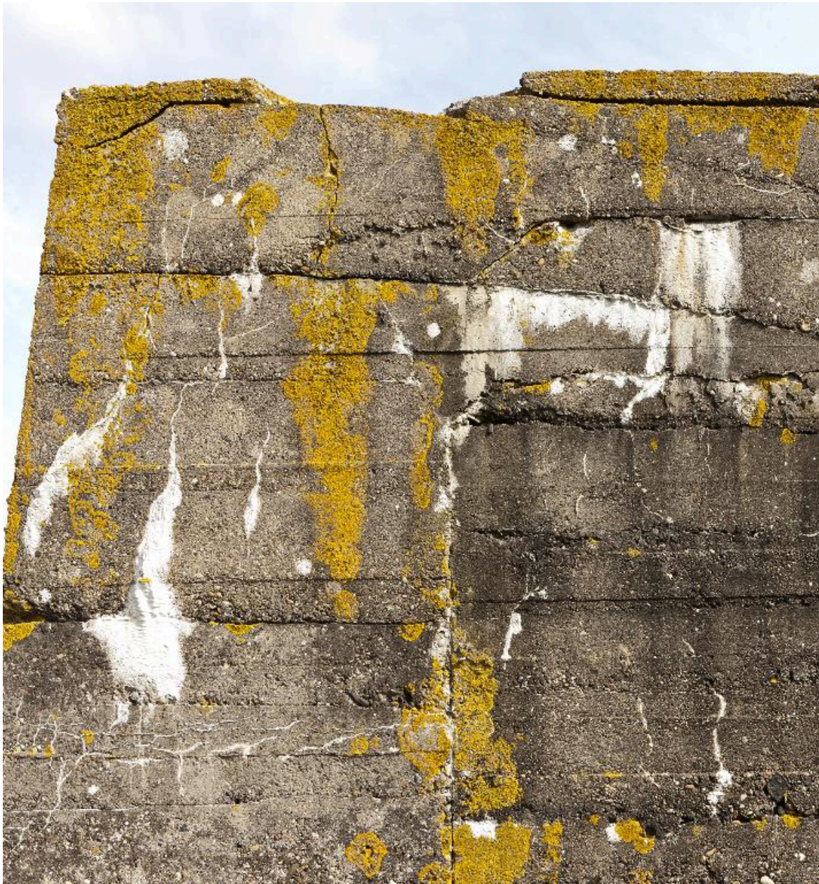
Raccord de plans de coulée sur l'élévation sud
