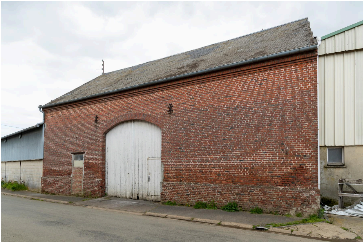
Grange reconstruite en brique, n°10 de la rue des Charrons, vue prise depuis le sud-ouest.
