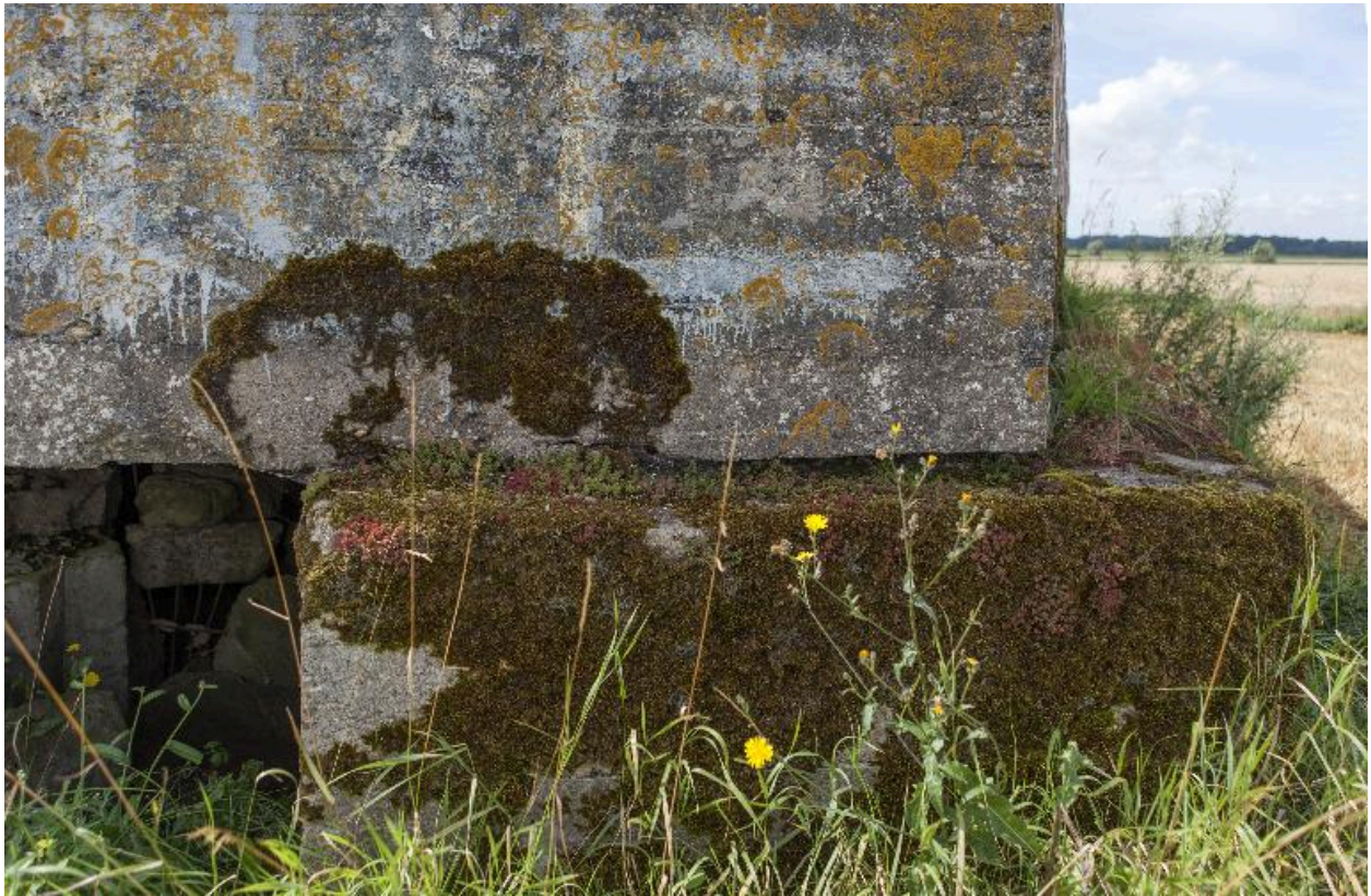
Angle nord-est. Effet du dynamitage de l'abris
