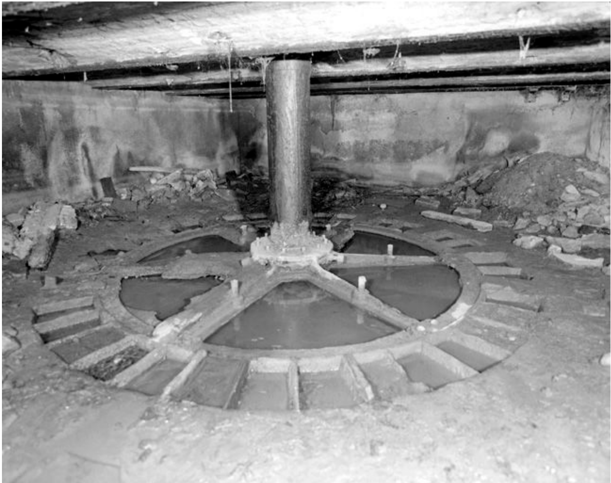
Bâtiment d'eau : turbine hydraulique.
