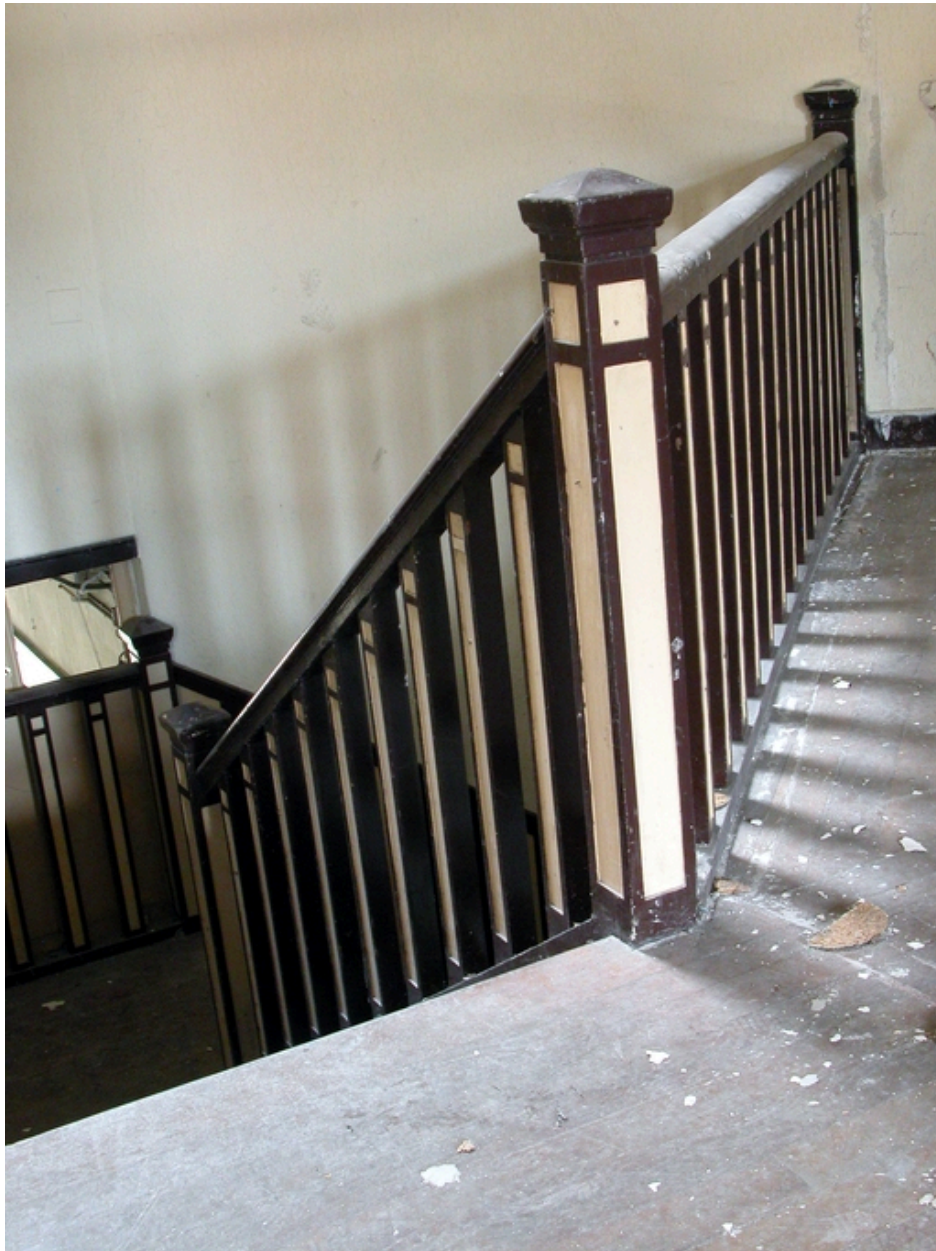
Escalier implanté à l'angle des rues de Mulhouse et Richard-Lenoir (premier étage), détail.
