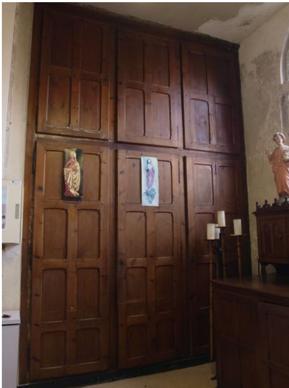
Placard sur mur nord
