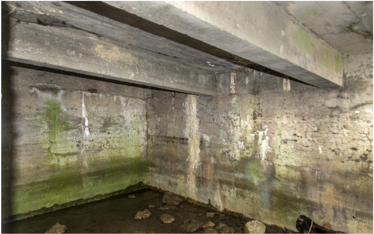
Les poutrelles de la soute à munitions depuis la chambre de tir.
